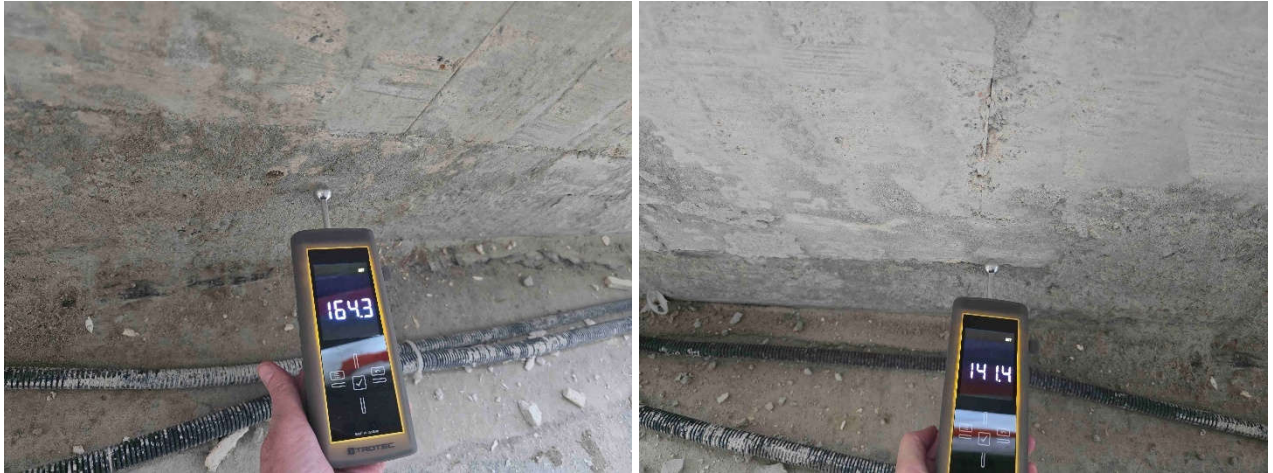
Abb. 21 + 22: Gruppenraum grün – EG-23: Der Wandsockel unterhalb der Fenster ist nass (hier 164,3 und 141,4 digits).
