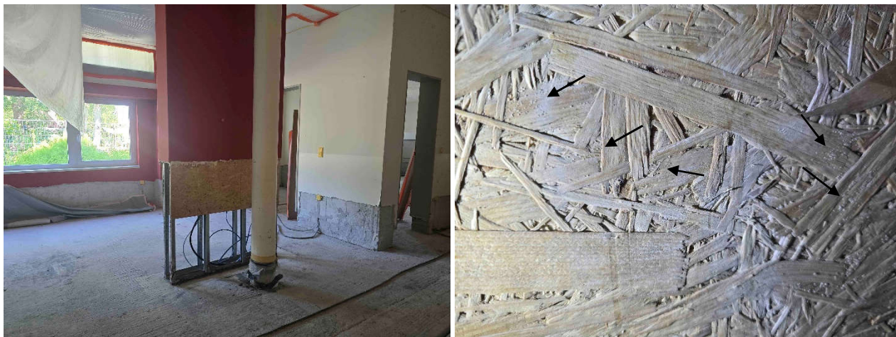
Abb. 1 + 2: Flur – EG-14: Die freigelegte OSB-Platte des Raumteilers verströmt einen stark muffigen Geruch. Im Streiflicht der Taschenlampe sind kleine „Pusteln“ auf der Oberfläche erkennbar, die mit einem Klebefilm beprobt wurden (Bild rechts).
